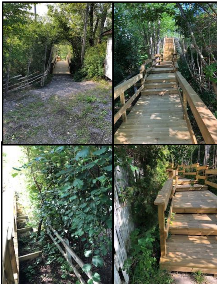
Figur 9. Utformning av trappan mellan fastighet Norra Lagnö 1:287 och Norra Lagnö 1:314. Bilderna är tagna under fältbesök 2019-08-22
