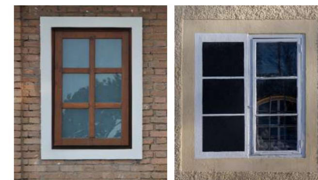
Exempel på omfattning runt fönster
