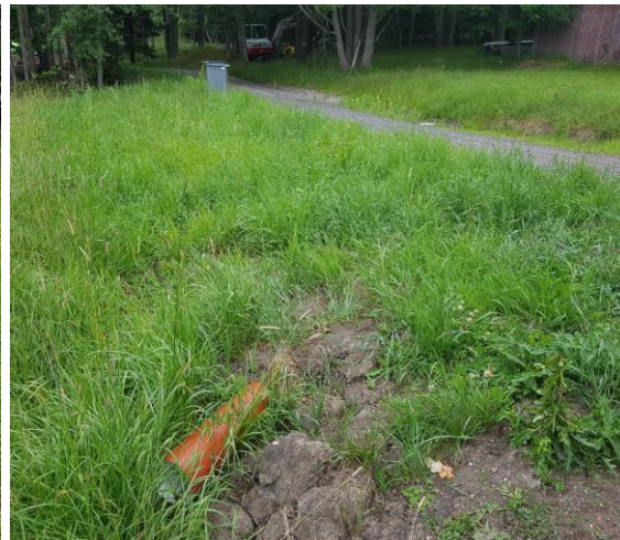
Foto 9 Ledningsmynning mot grönytan på motsatt sida. OBS! Ej samma ledning som syns i foto 8
