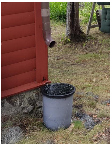
Figur 26 Stuprörsutkastare med regntunna.
