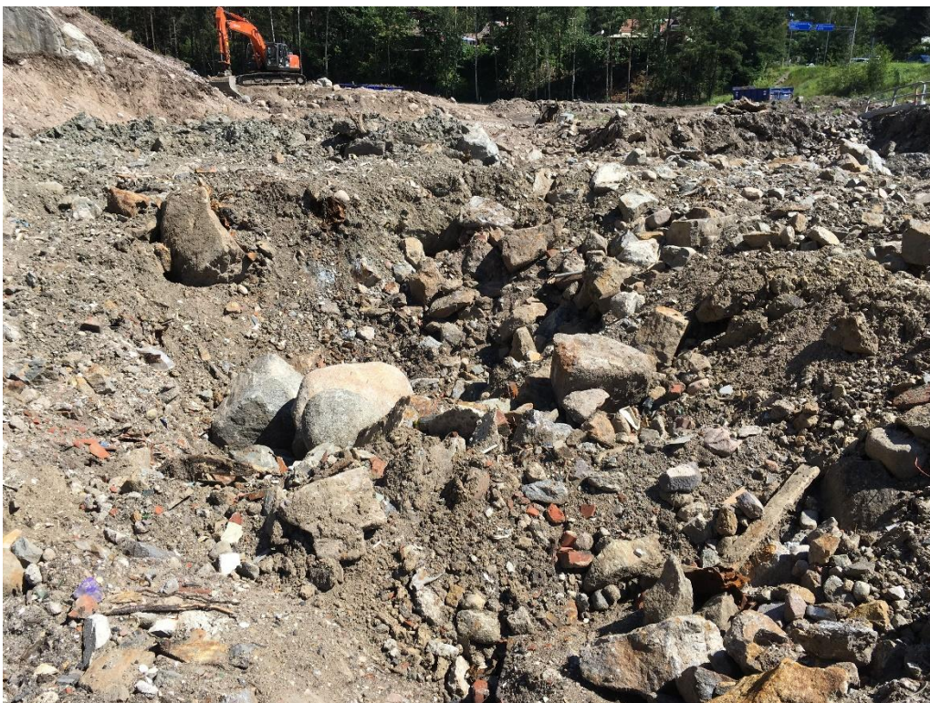
Figur 2. Fyllnadsmassor inom tippområdet. Fyllnadsmassorna innehåller bland annat tegel, träbitar, metall, glas och plast.
