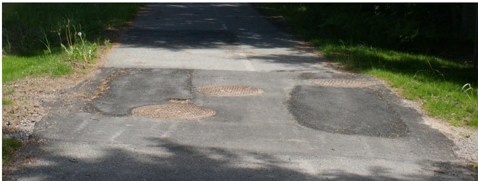
Lappat och lagat med tendens till potthåll i gång- och cykelväg i Stavsnäs
